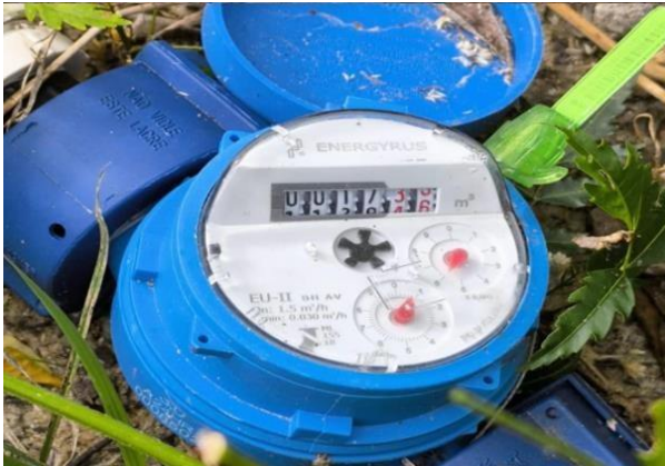
Figura 04. Hidrômetro instalado na saída do recalque.
