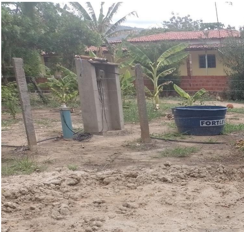
Figura 5. Sistema de recalque da água do poço semiartesiano.
